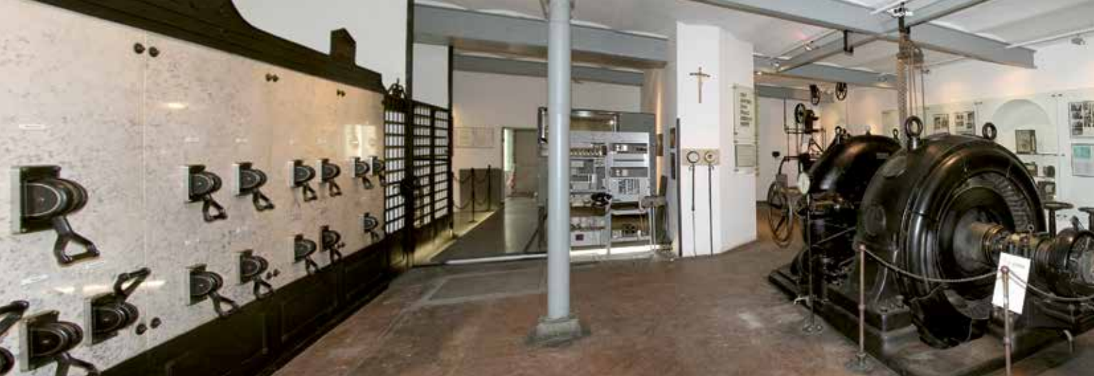
Alles begann mit dieser Turbine und der Schaltwand aus Marmor.
